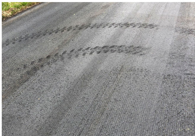
Ślady opon widoczne na siatce
